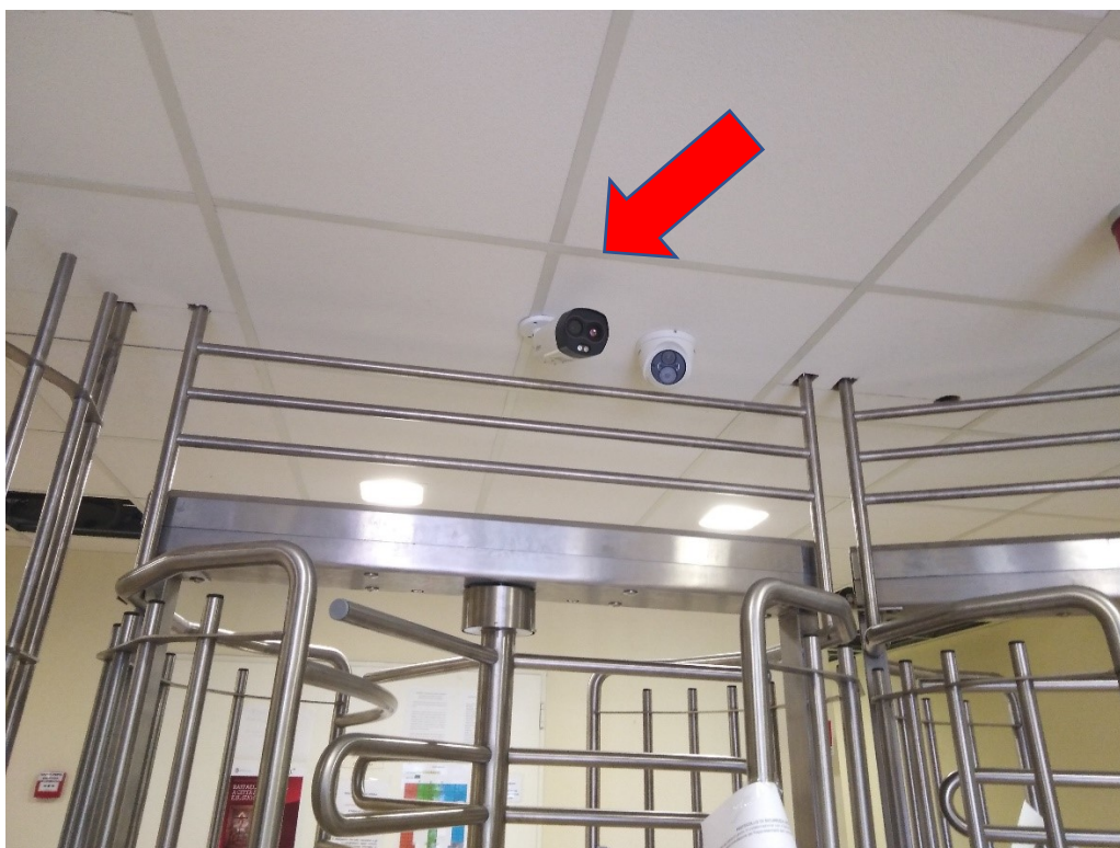
TELECAMERA A INFRAROSSI POSTA A SOFFITTO (INGRESSO DIPENDENTI BROLETTO)
