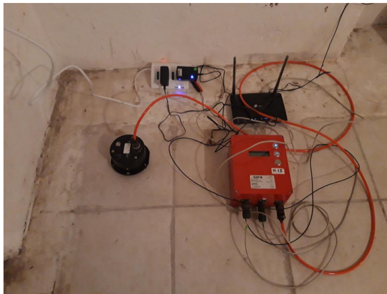
Stazione accelerometrica di Giano dell'Umbria (BRDO, presso Istituto Superiore di Bastardo)
