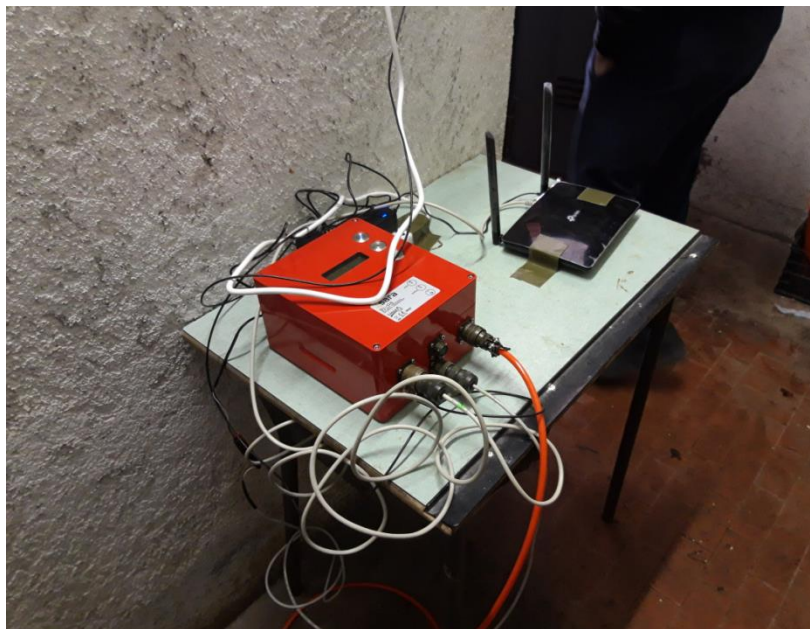
Stazione accelerometrica di Cascia (CSCA).
