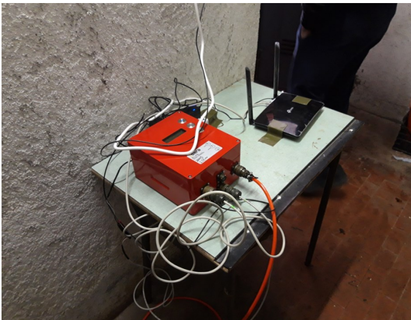
Stazione accelerometrica di Cascia
